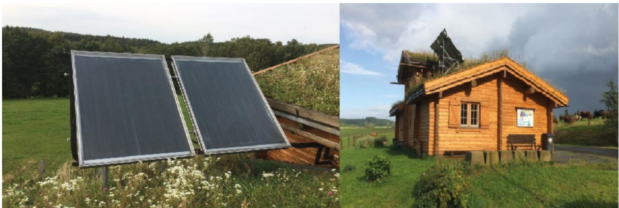
Abbildung 21: Solarthermie-Kollektoren beim Ökologischen Innovationszentrum. EIC 2022.
