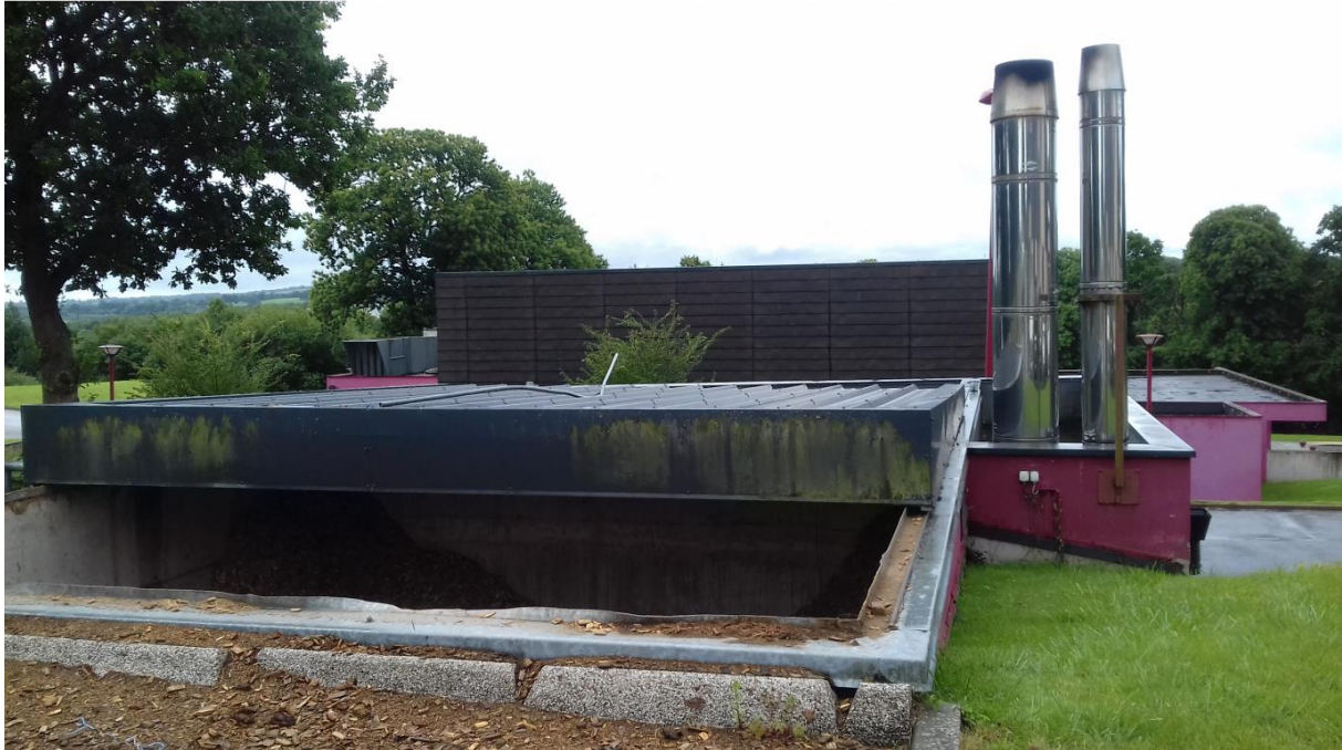
Abbildung 27: Das Holzheizkraftwerk in Collinée. Lehec 2021.
