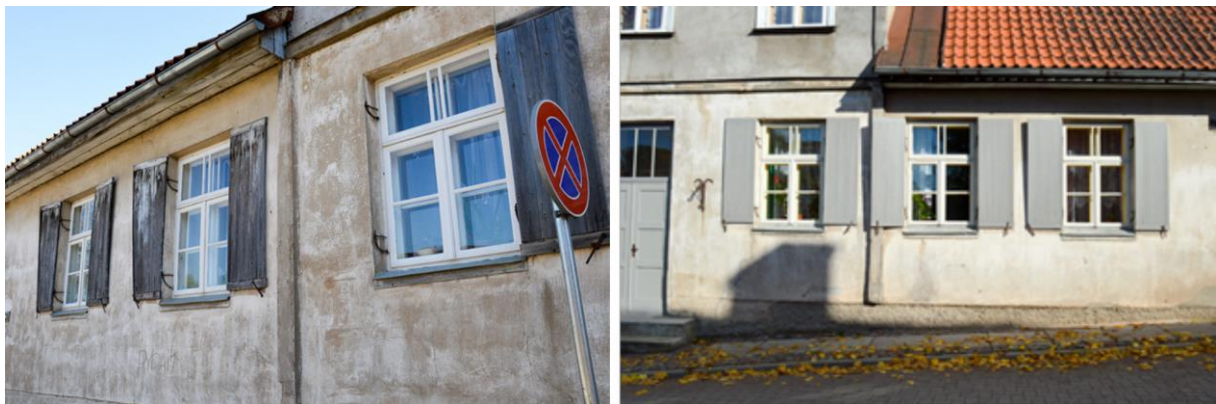
Abbildung 70: Projekt Mūsu mājai in der Kalku-Straße 7, Kuldīga. Links die Fassade des Gebäudes vor der Sanierung, rechts nach der Renovierung. Bezirk Kuldīga.
